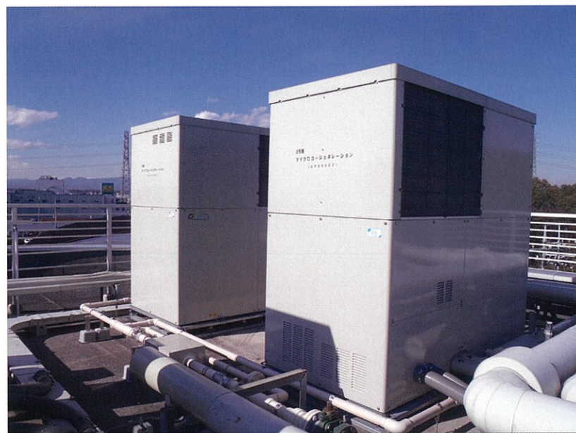
▲GHP(ガスヒートポンプ)の施行例
