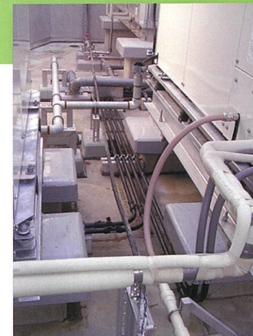
▲屋外 ガス配管
